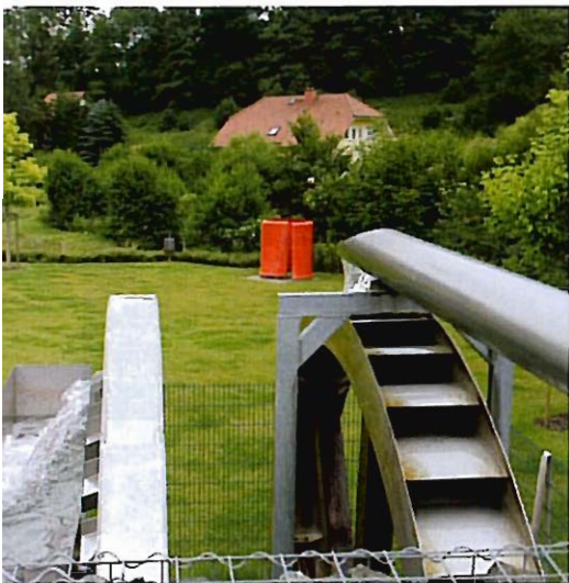
Das mit dem Wasserrad mitlaufende Schöpfrad befördert das Schwimmbad-Ablaufwasser in die vollbiologische Kläranlage und hält somit auch den Wasserkreislauf im Naturfreibad in Gang.
